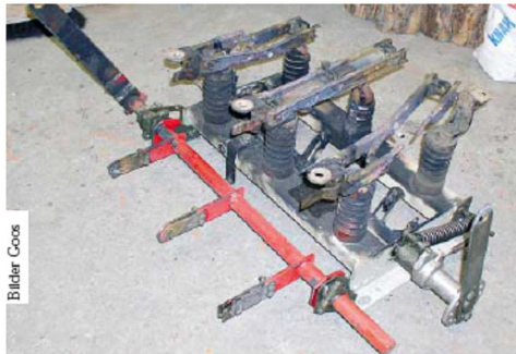
Der zerstörte, ausgebaute 10-kV-Schalter (in rot: Erdungs- und Kurzschließschalter).
