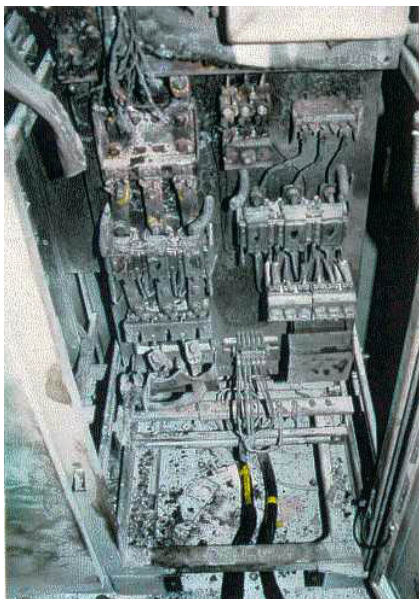
Bild: Zustand einer NS-Hauptverteilung nach einem Störlichtbogenunfall.
