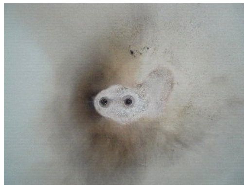
Bild 2: Deutlich erkennbar sind die Überschlagsspuren an der Schaltfeldtür.
